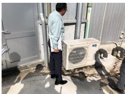
空調室外機を確認
