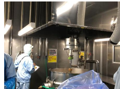
蒸気・熱の排出状況を確認
