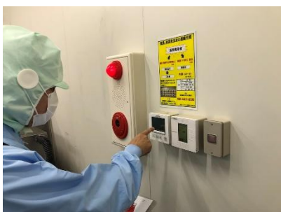
各部屋の空調運用状況を確認
