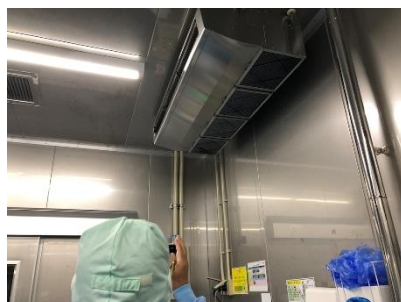
空調機のフィルターを確認
