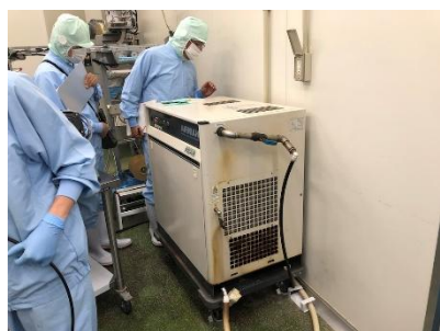
コンプレッサーの稼働状況を確認
