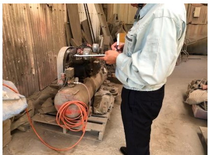
コンプレッサーの稼働状況を確認
