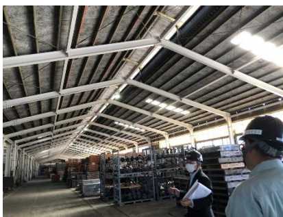
工場内の照明を確認
