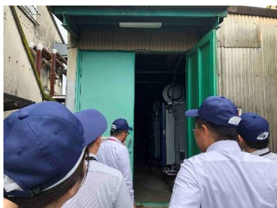
めっき液を温めるためのボイラー設備
