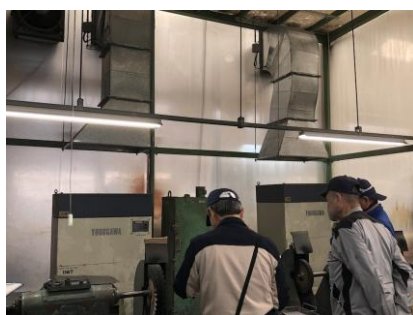
集塵機の動作状況を確認
