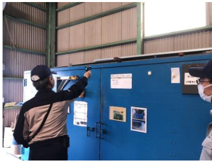
乾燥機の温度を計測
