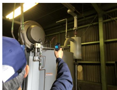
ボイラーからの放熱を確認
