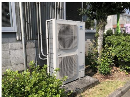
強い日差しを受ける空調室外機
