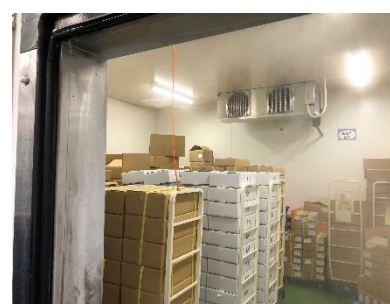
商品を保管する冷凍庫
