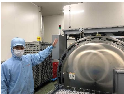
重油ボイラーで稼働するレトルト殺菌機
