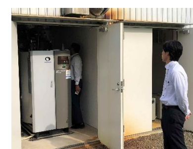
屋外のボイラー設備
