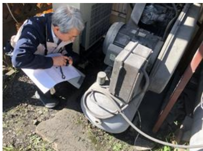
コンプレッサーを確認
