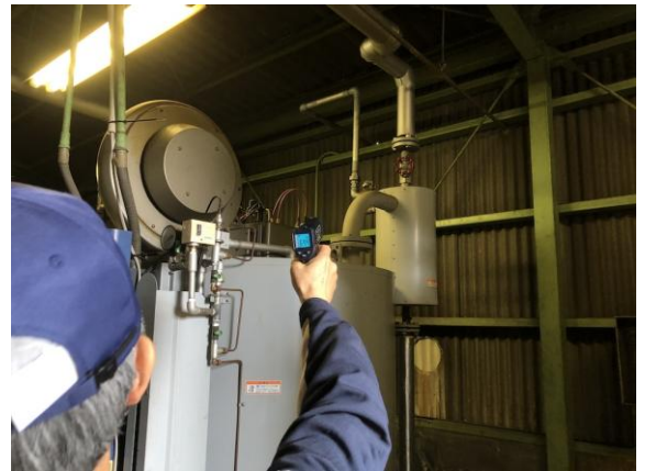
▲ボイラーの温度を確認
