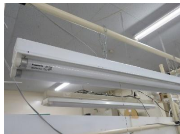
各棟の照明を確認
