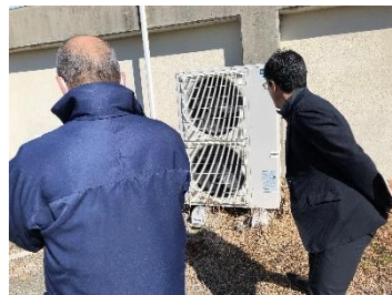
空調機室外機を確認
