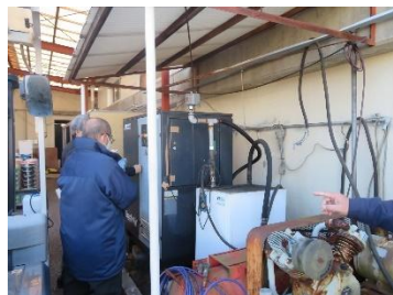
コンプレッサーを確認
