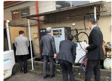
コンプレッサーを確認
