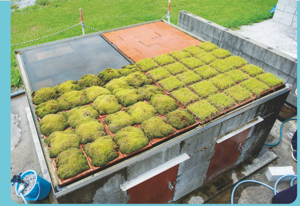
実証実験を行った屋上緑化模擬試験設備。内部は4つの空間に分かれています
