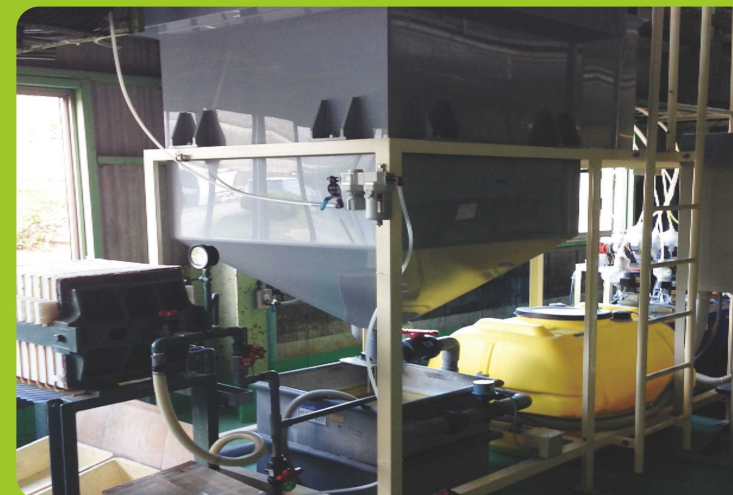
今回開発した錫回収装置。 毎分10リットルの排水を処理することができます
