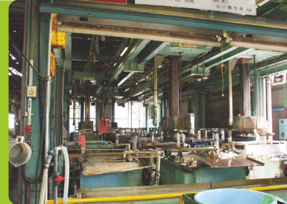
工場内のめっきライン
