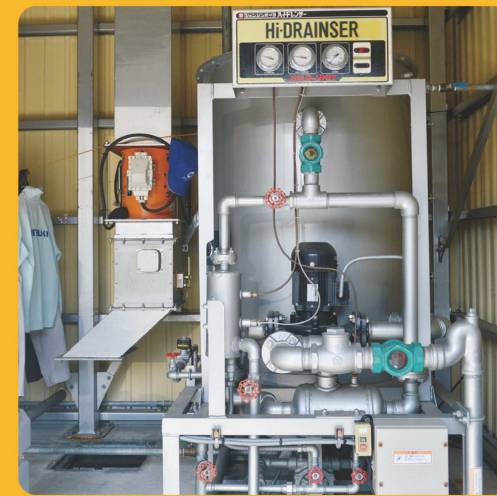
生産されたエタノールは工場内にあるボイラーの燃料などに利用されています
