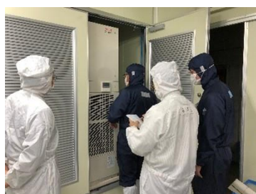
クリーンルーム内の空調機を確認
