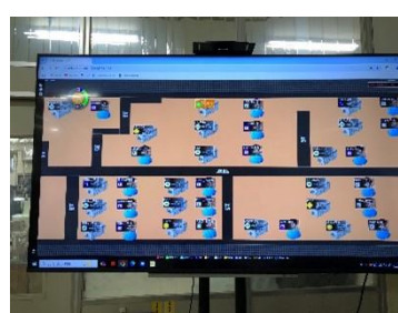
設備の稼働状況が“見える化”されている
