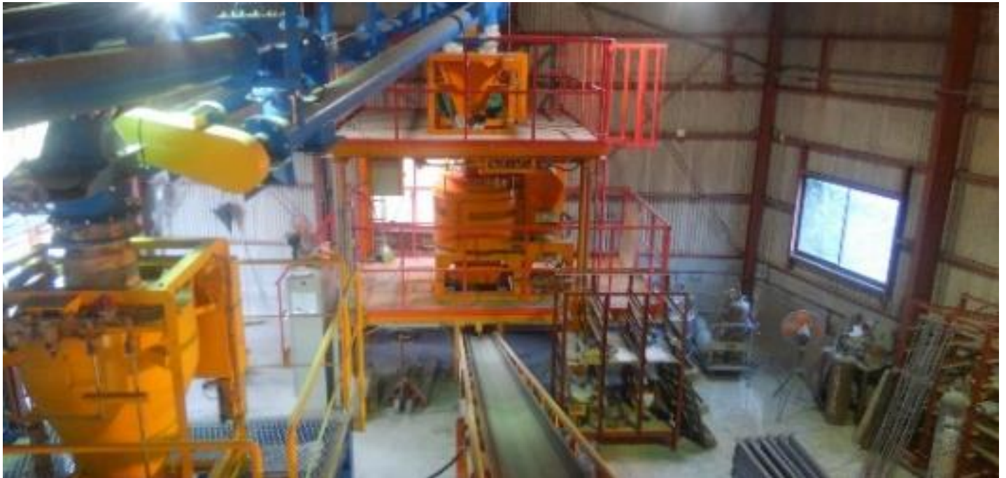
▲スノコ生産用バッチャープラント
