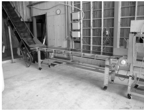
▲甘藷洗浄製造ライン
